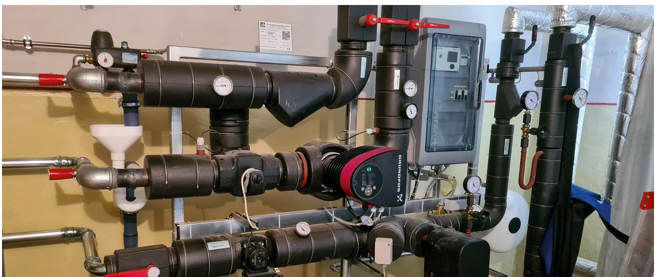
Moderne Wohnungsstationen mit dezentraler Warmwasseraufbereitung
